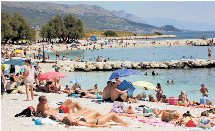
I bagnanti sulla spiaggia di Žnjan non si sono lasciati impressionare dai lavori in corso e sono stati numerosi anche nel mese di settembre
