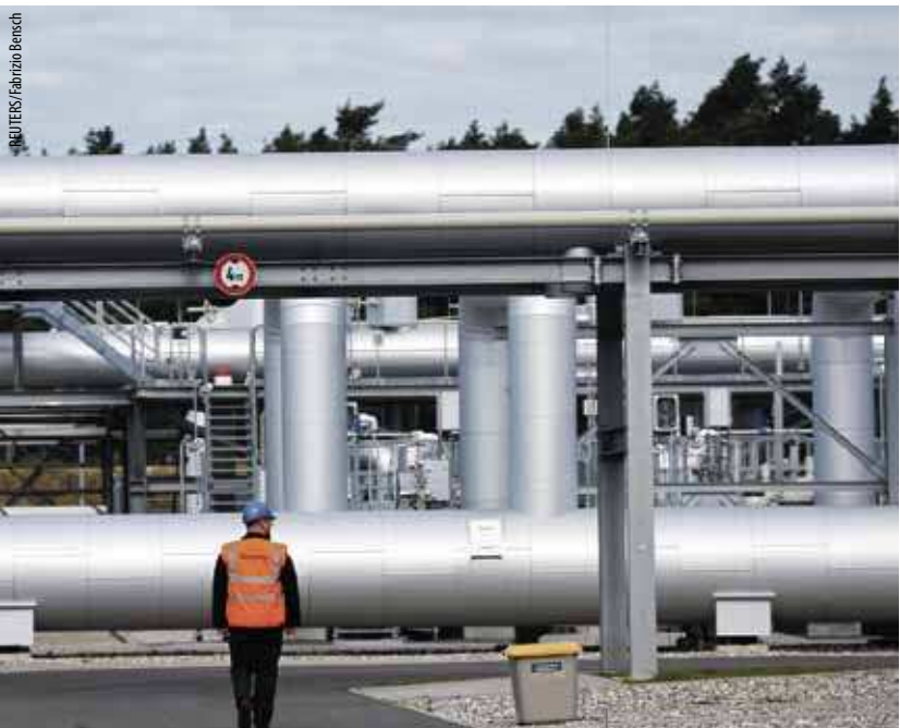
L'impianto Nord Stream 2 a Lubmin
